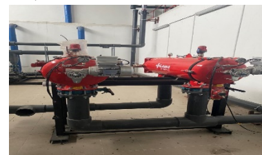
Stația de tratare
